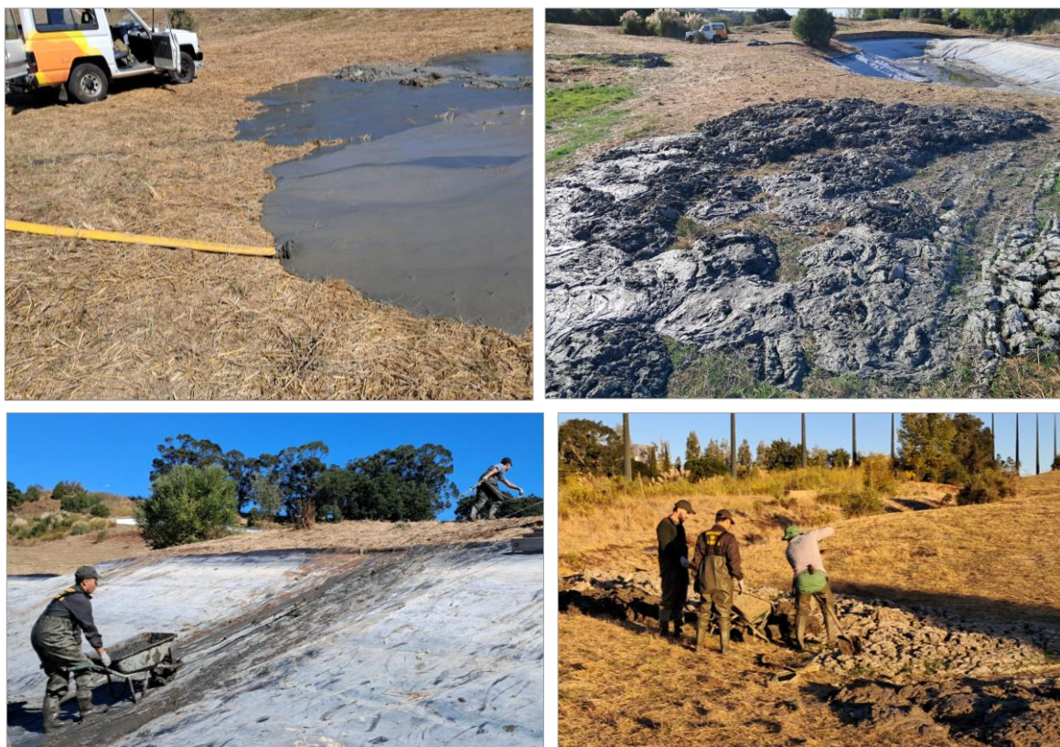
Figura 14. Deposição de sedimentos provenientes dos lagos do campo de golfe nas margens
