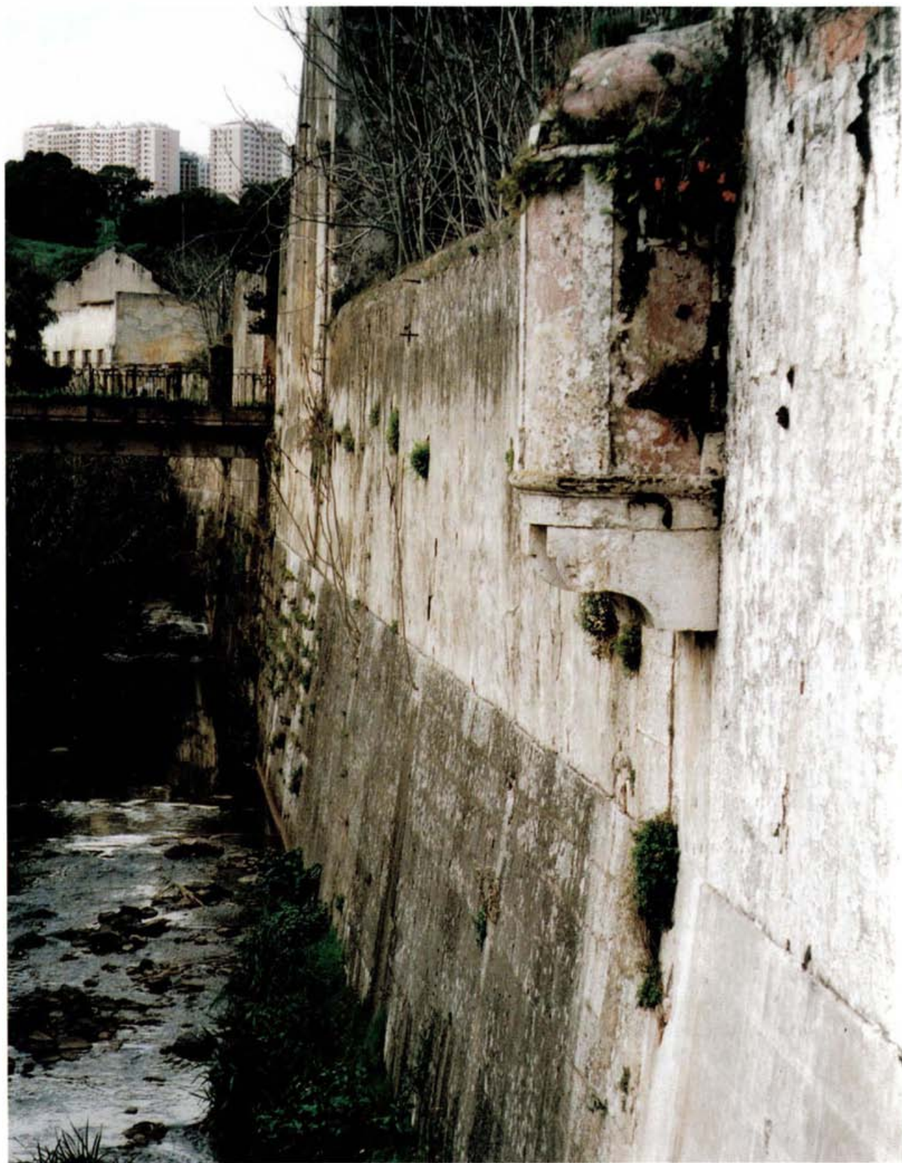
Fot. 10 - Muros com revestimento de cantaria de boa qualidade marginando a ribeira de Barcarena. Observa-se em primeiro plano uma guarita de sanitários.
