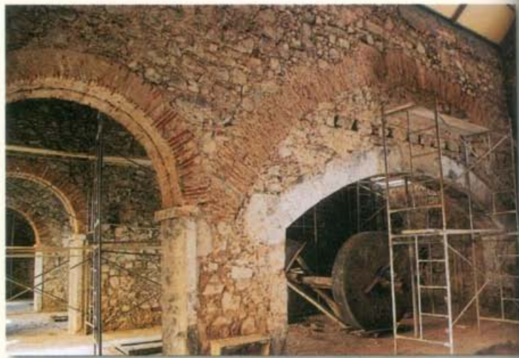
Fig. 40 - Remoção de rebocos das paredes interiores do edifício da Fábrica de Baixo, para reconhecimento de elementos estruturais.
