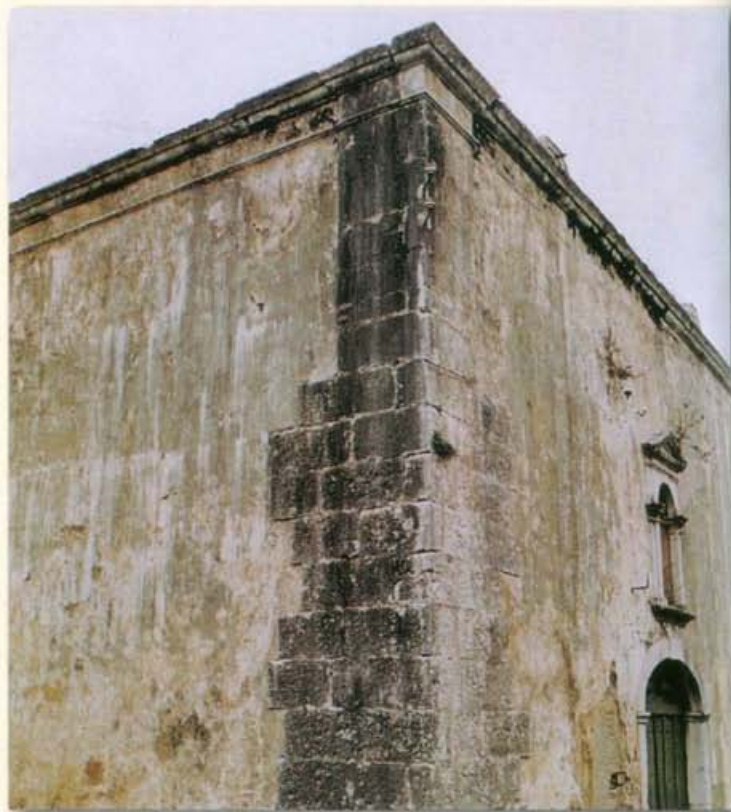
Fig. 17 - Cunhal de alvenaria do canto sudeste da Fábrica de António Cremer, antes da recuperação, cujo aparelho evidencia duas fases construtivas.
