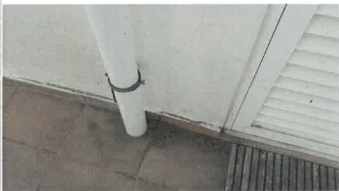
Foto 6 - Tubo de queda de descarga no terraço
