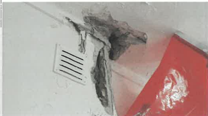
Foto 1 - Teto instalação sanitária na fração 7.º Esq.º
