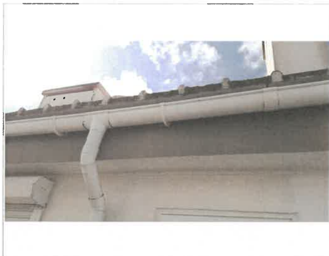
Foto 7 - Caleiras de recolha de água
