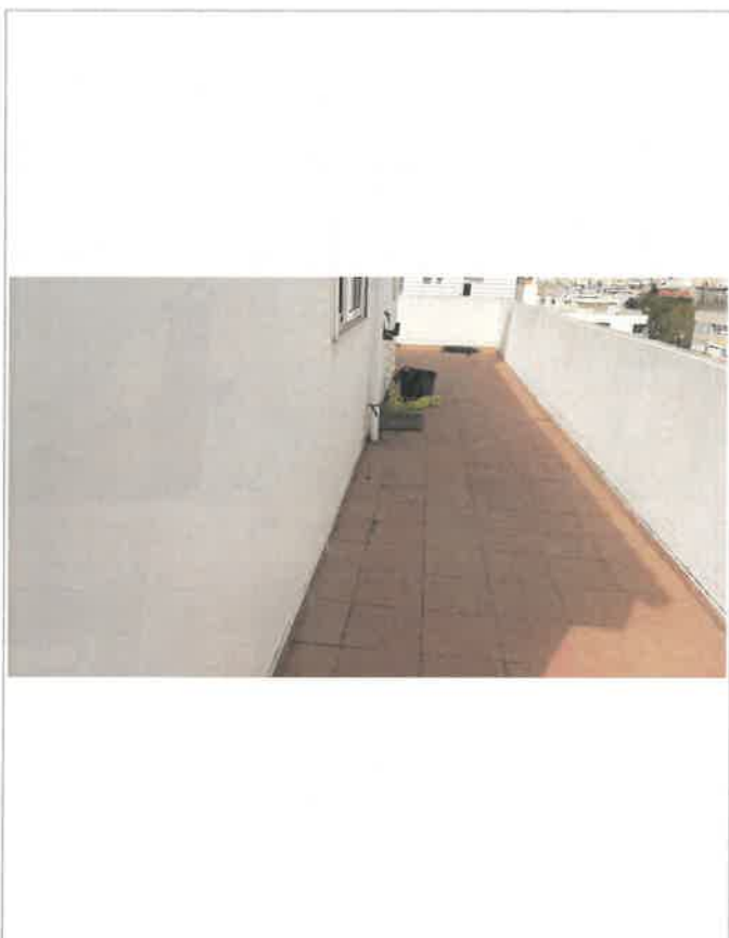
Foto 9 - Zona do terraço (onde ocorre a infiltração)
