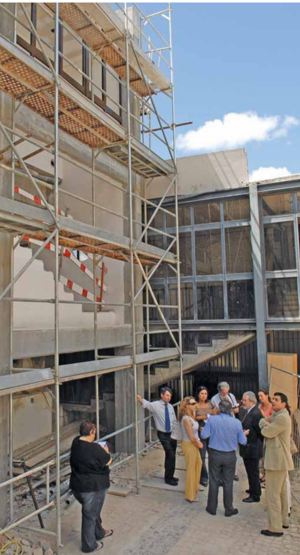
O presidente da Câmara com o presidente da Junta de Freguesia de Queijas, Ricardo Barros, em visita às obras de ampliação do lar e centro de dia da Paróquia de S. Miguel
