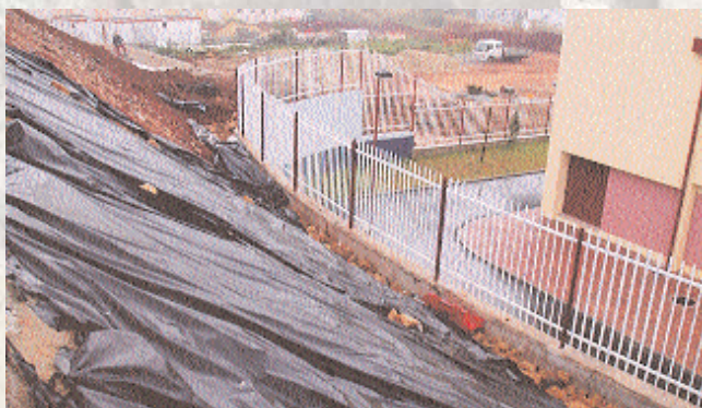
Contenção de taludes junto à Escola Básica 2.3 de S. Bruno em Laveiras, Caxias
