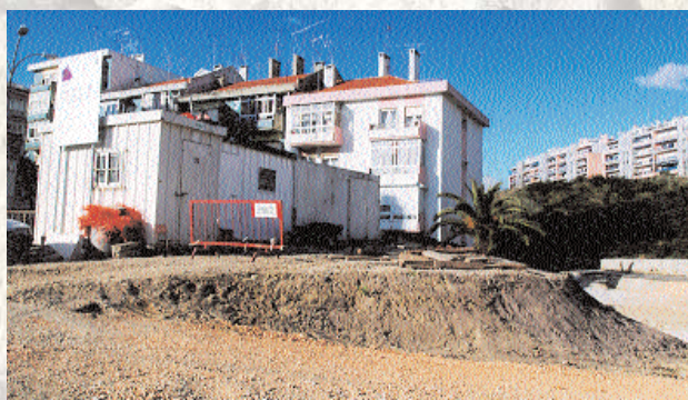
Colocação da câmara de grades na Ribeira da Junça, em Cruz Quebrada
