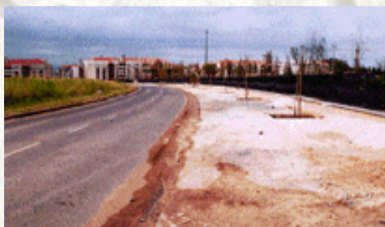
Colocação de colector pluvial na rua de São Salvador da Baía em Oeiras
