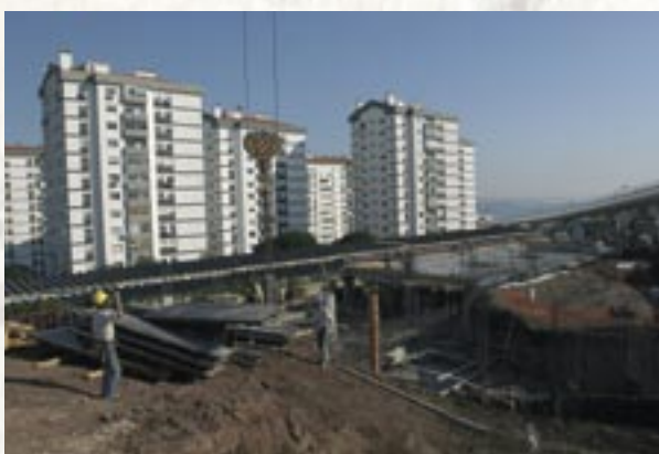
Início das obras de construção da extensão do Centro de Saúde de Oeiras em Paço de Arcos
