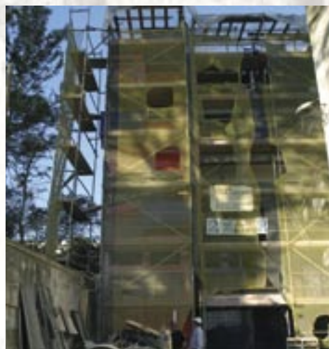
Obras de adaptação do antigo quartel de Bombeiros à Extensão do Centro Saude do Dafundo
