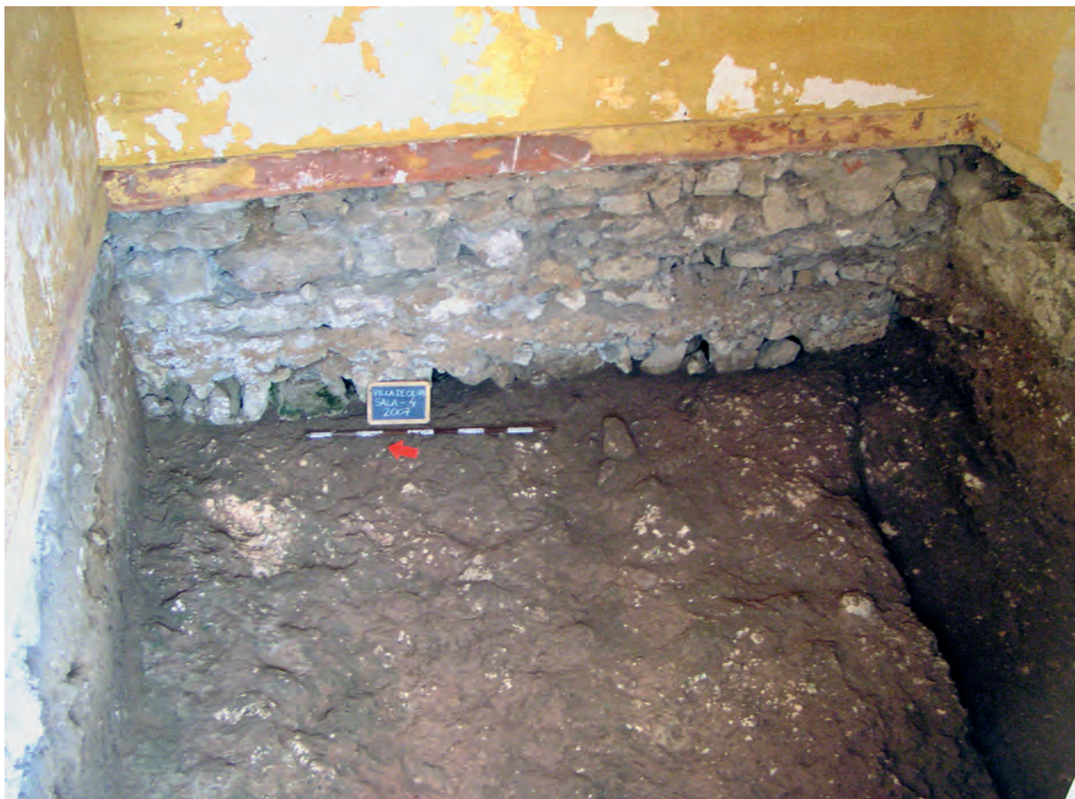
Fig. 5 – Vista parcial da escavação efectuada na Sala 4, observando-se ao fundo a fundação de uma das paredes mestras da casa setecentista, fundada no substrato geológico, em primeiro plano, o qual evidenciou um roço rectilíneo, correspondente à fundação de uma parede da Idade do Ferro, visível do lado direito. Foto J. L. Cardoso.
